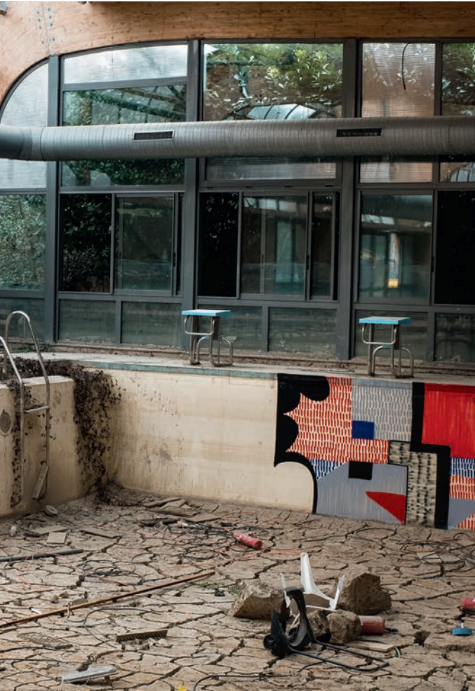
La piscine de Breil-sur-Roya n'a jamais été réhabilitée après le passage de la tempête Alex en 2020.
